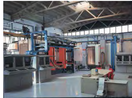
Esempio di impianto polvere
