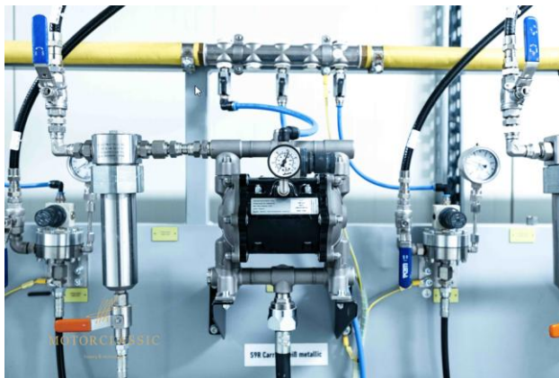
Alimentazione della vernice con pompe a doppia membrana ZIP 52 e varie stazioni di sollevamento del coperchio del fusto
