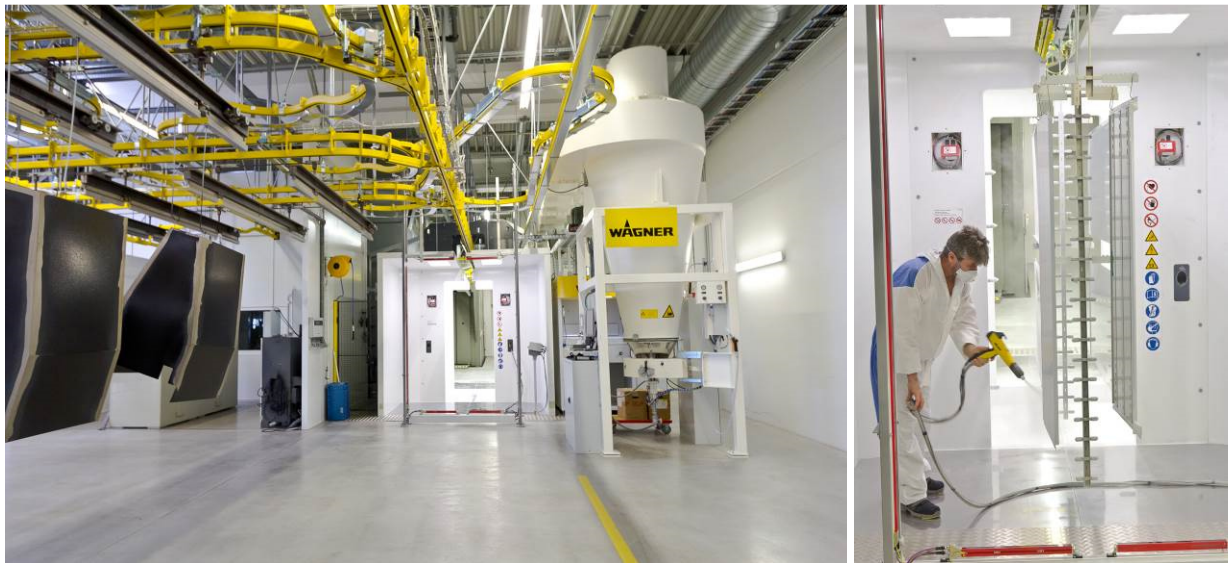
Bilder: Die gesamte Anlage bietet viel Raum und Licht zum Arbeiten
