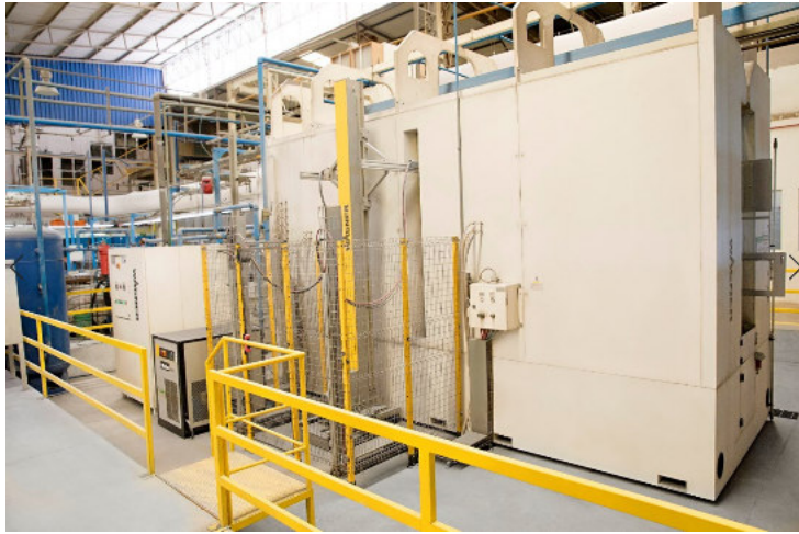
Die Rückseite der Pulverkabine mit Hubgerät und Luftaufbereitungssystem.
