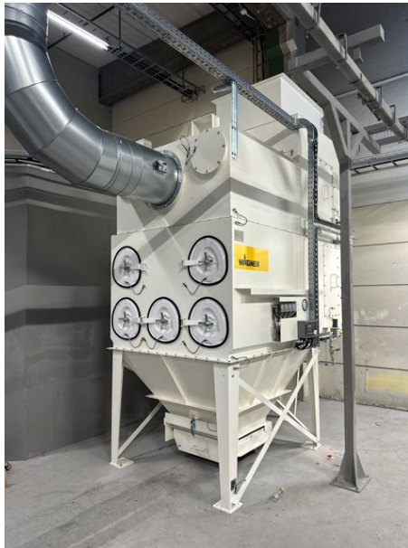
Nachfilter der neuen Pulverbeschichtungslinie
