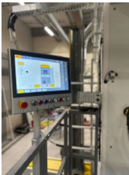
Sistema di controllo WICOS per il monitoraggio del processo di verniciatura
