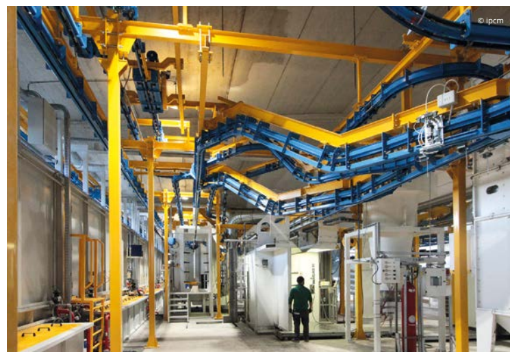
Vista della zona di applicazione con dettaglio degli scambi del trasportatore birotaia Futura Convogliatori Aerei (Robecco Pavese, Pavia) che creano i buffer necessari a dare flessibilità all'impianto.
