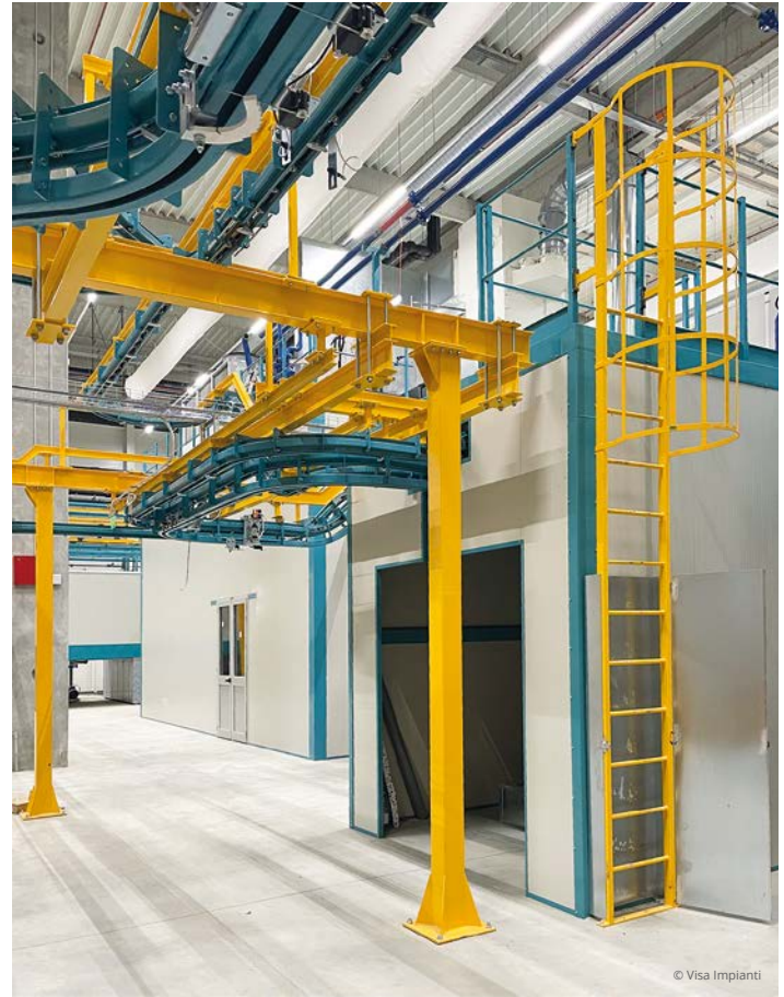
Un dettaglio dell'impianto di verniciatura fornito da VISA Impianti.
