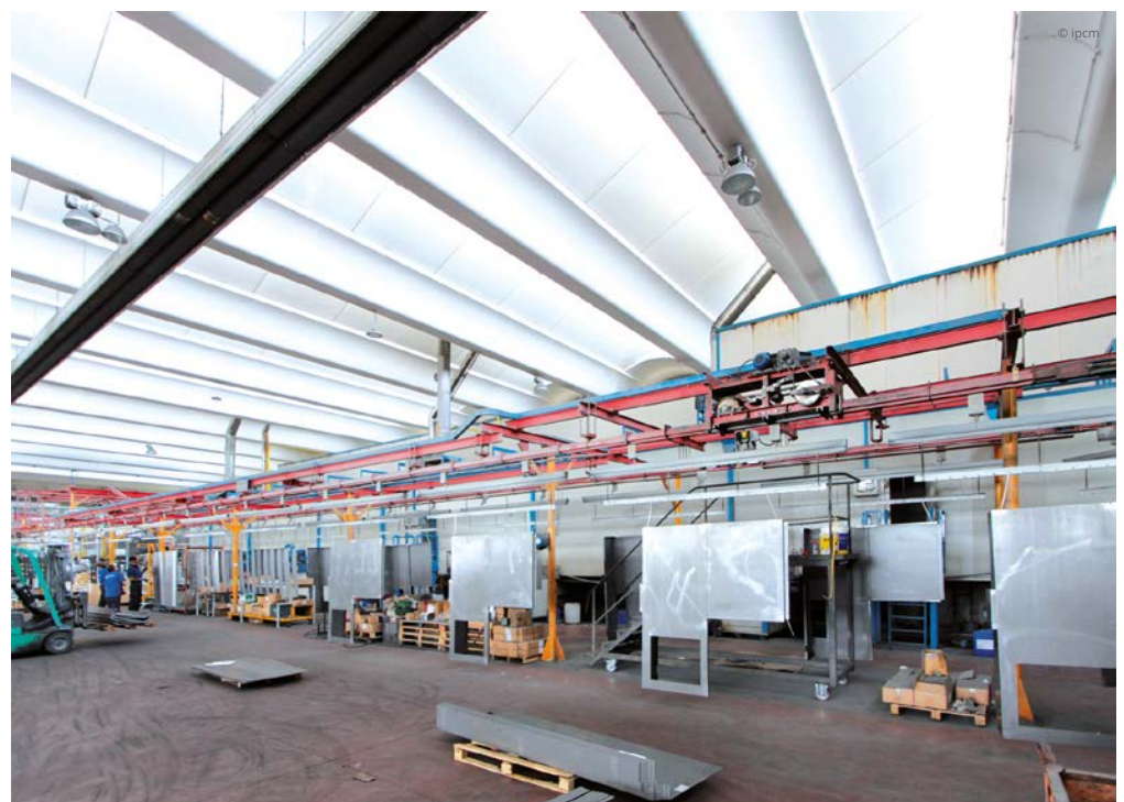
Vista generale della linea di verniciatura progettata da Imel e realizzata dalla stessa Nord Laser.
