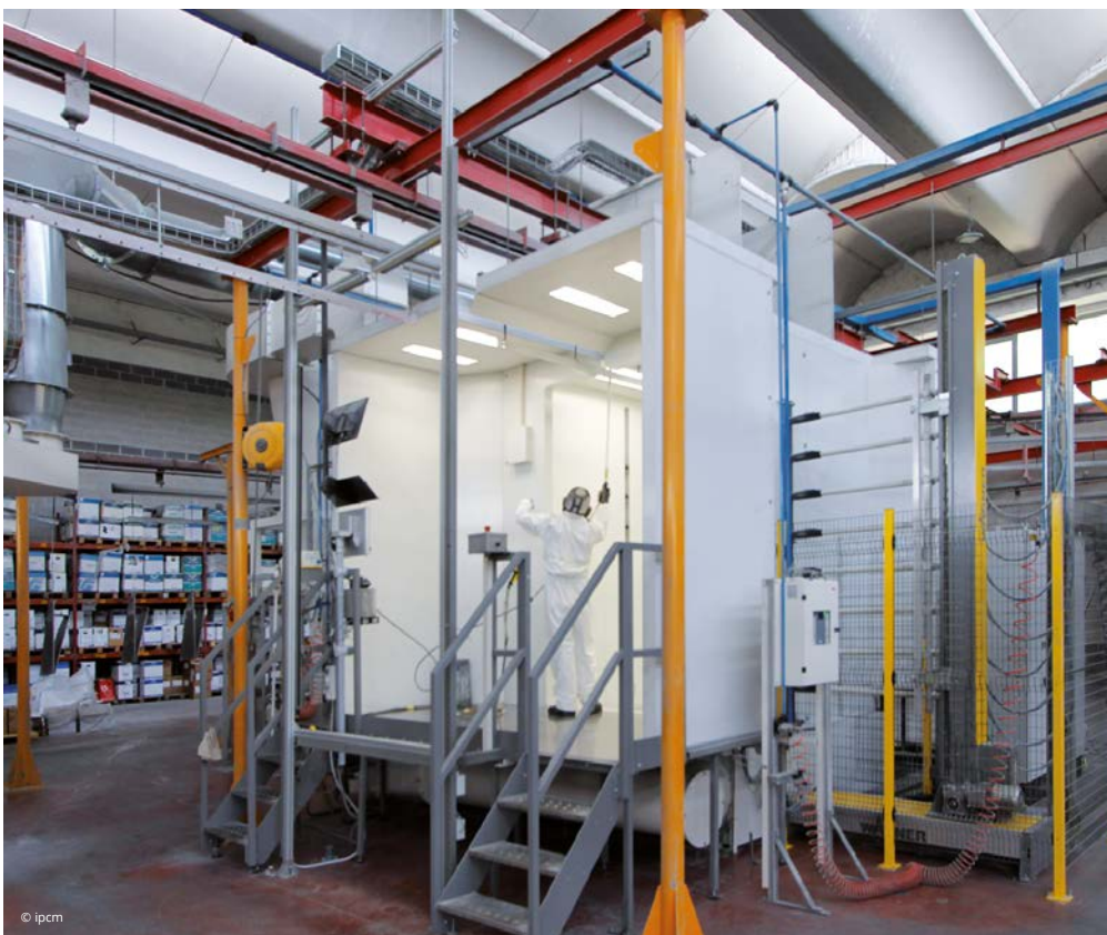
L'intervento dell'operatore è ridotto alla sola pulizia della cabina con aria compressa.
