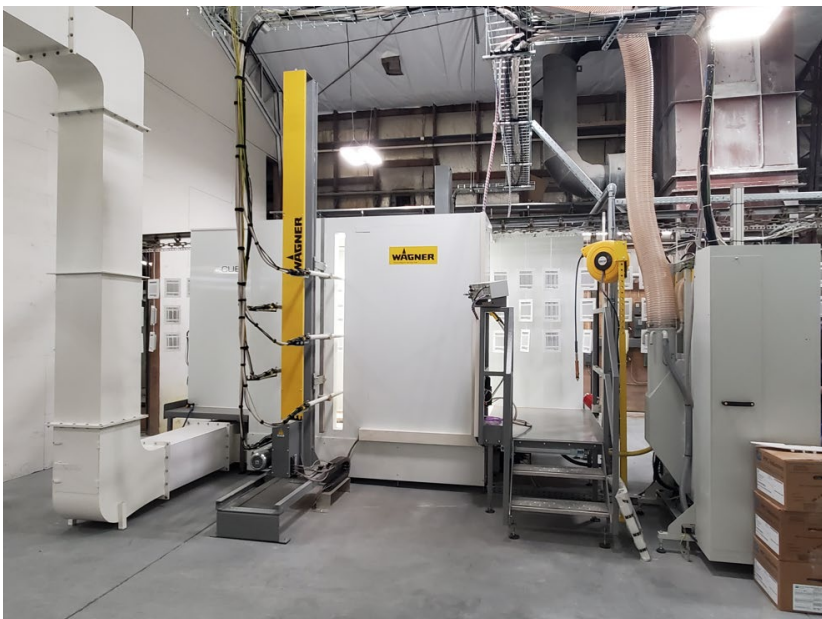
Neue E-Line Anlage bei Shoemaker mit Kabine, Pulverzentrum, Zyklon und Filter
